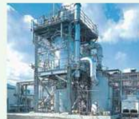
ASAHI PRETEC EHIME 공장 / 고온열분해장치
