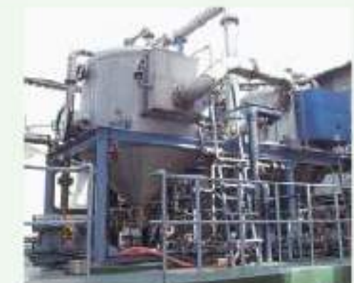
ASAHI PRETEC KOBE 공장 / 폐액농축장치
